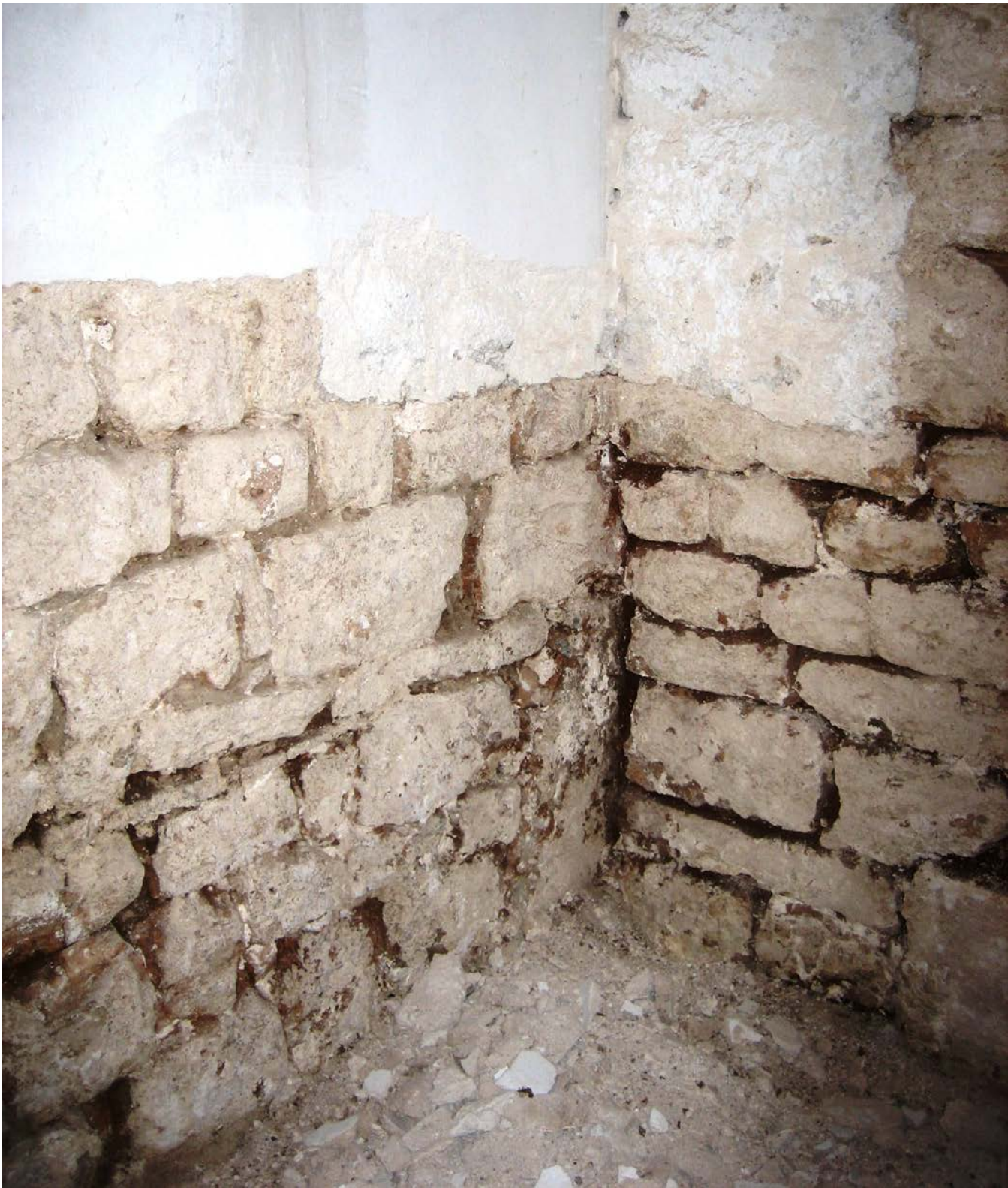
Murature slegate in controfacciata della navata sinistra
